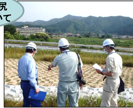
高津町堤防裏法尻補強の説明
