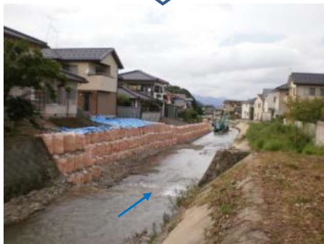
＜弘法川＞ 護岸が約80m損壊 大型土のう 約240個で応急復旧 (8月28日完了)
