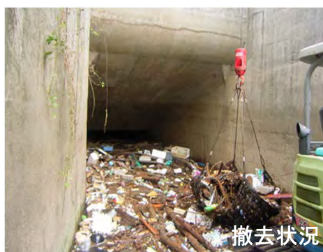
呑口堆積状況
