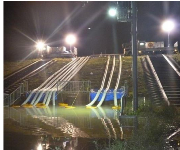
【排水ポンプ車稼働状況】
