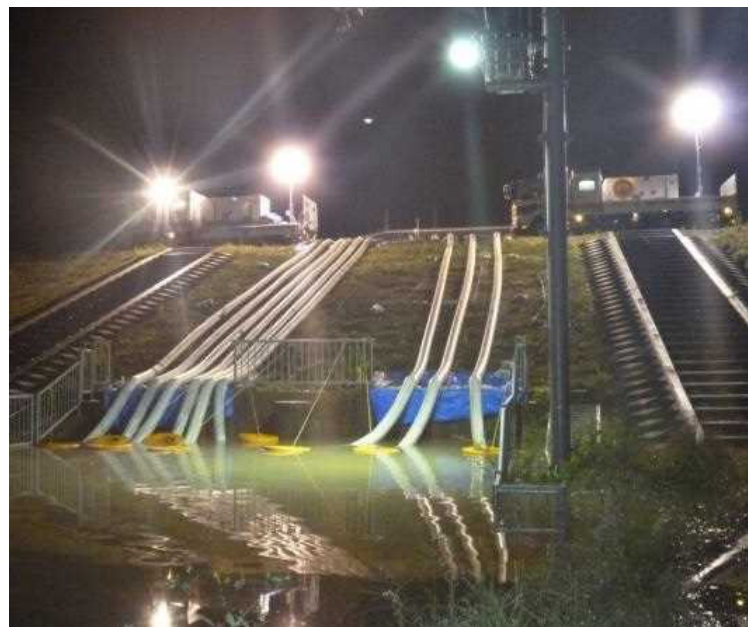
【排水ポンプ車稼働状況】
