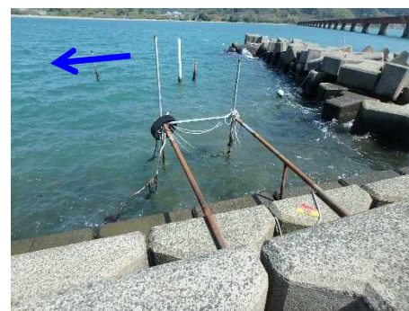
係留用施設 消波ブロック
