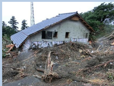
写真2.平成25年台風26号による土砂災害 (出典：気象庁HP)
