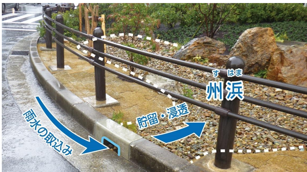
写真7. 京都市が整備している雨水貯留設備(雨庭)
