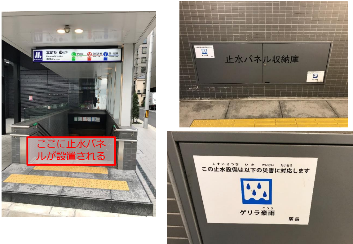
写真6. 大阪メトロ本町駅の止水パネル
