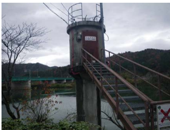
写真 4.4.1 水位観測所（大川橋）
