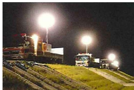
排水状況(荒河排水機場、H30.7/7)
