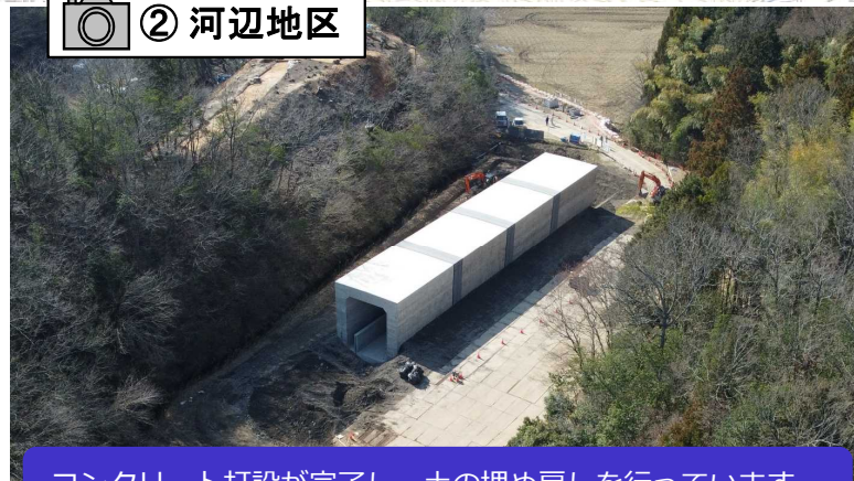
コンクリート打設が完了し、土の埋め戻しを行っています。
