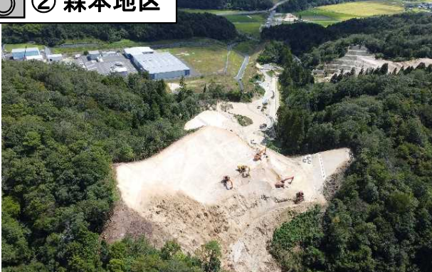
幅員 3 mの工事用道路をつくるため、引き続き山を掘削して土砂を搬出しています。
