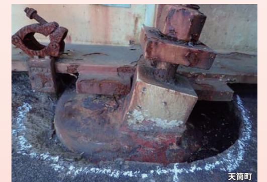
支承の沈下傾斜状況
