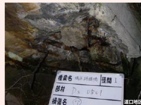
床版の剥離・鉄筋露出
