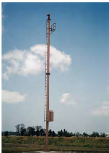
CCTV設置状況
