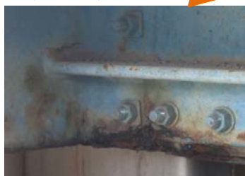
水密ゴムの劣化
