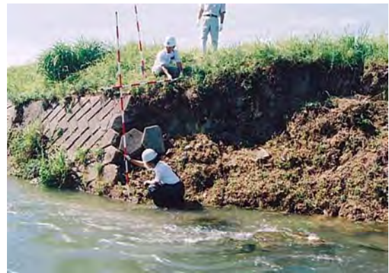
兵庫川 護岸被災（坂井市坂井町若宮）
