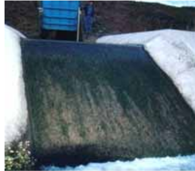
北川との落差 230cm (瓜生第 1 排水樋門)
