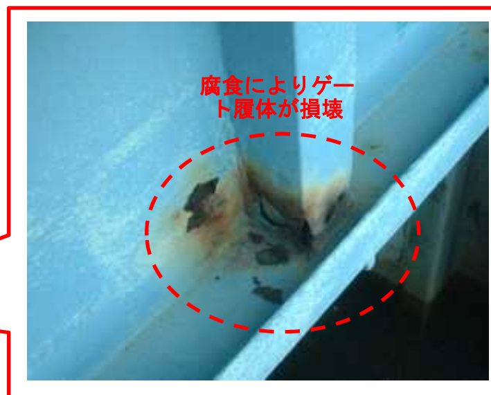
ゲート腐食部
