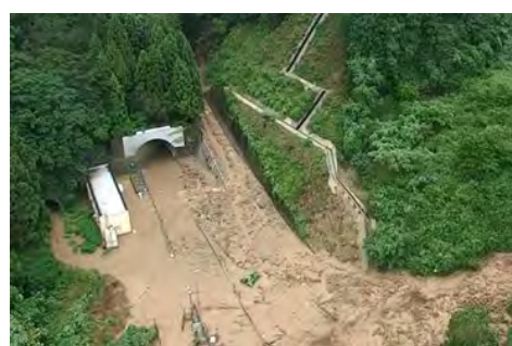
北陸自動車道 被災状況
