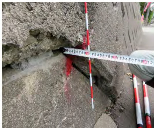
壁面変状(ズレ)状況
