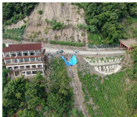
国道8号被災状況
