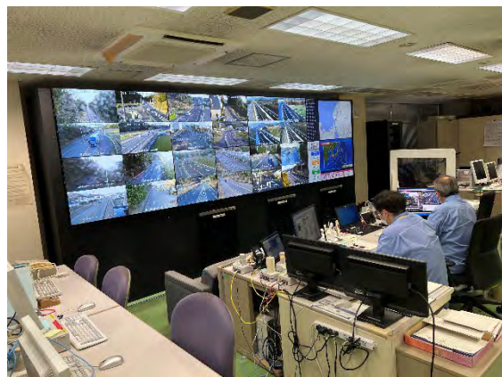
道路情報室(CCTV画像監視状況)
