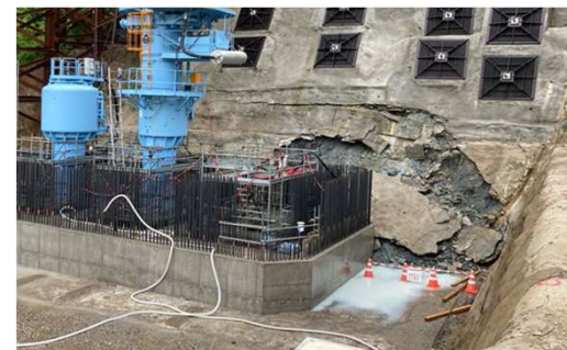
写真2 崩壊した切土法面
