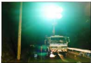
一般国道305号線 土砂崩れ 出動 (福井県丹生郡越前町厨地先)
