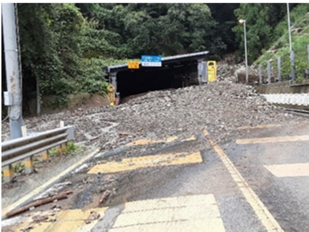
写真① 並行する国道8号 【豪雨による土砂流出状況】
