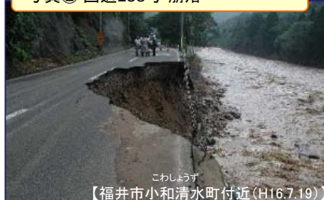
写真② 国道158号 崩落
