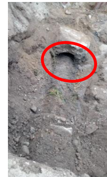
横断水路継ぎ目部に隙間が発生
