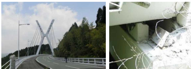
写真-2 支保部の損傷に伴う桁端部の浮き上がり (県道熊本高森線・桑鶴大橋)
