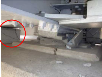
写真-6 支承の破損の状況
