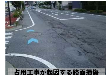
占用工事が起因する路面損傷
