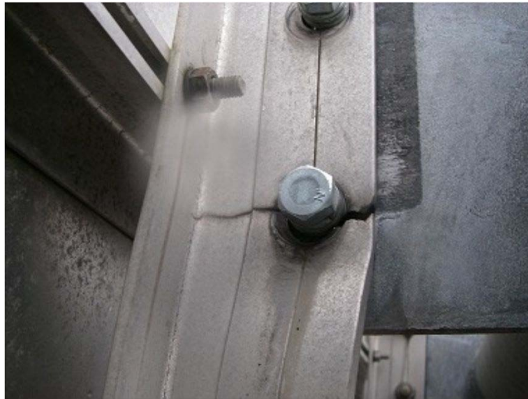
き裂損傷 (車両衝突)
