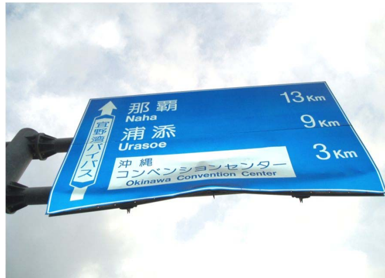
異常変形 (車両衝突)
