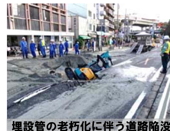
埋設管の老朽化に伴う道路陥没
