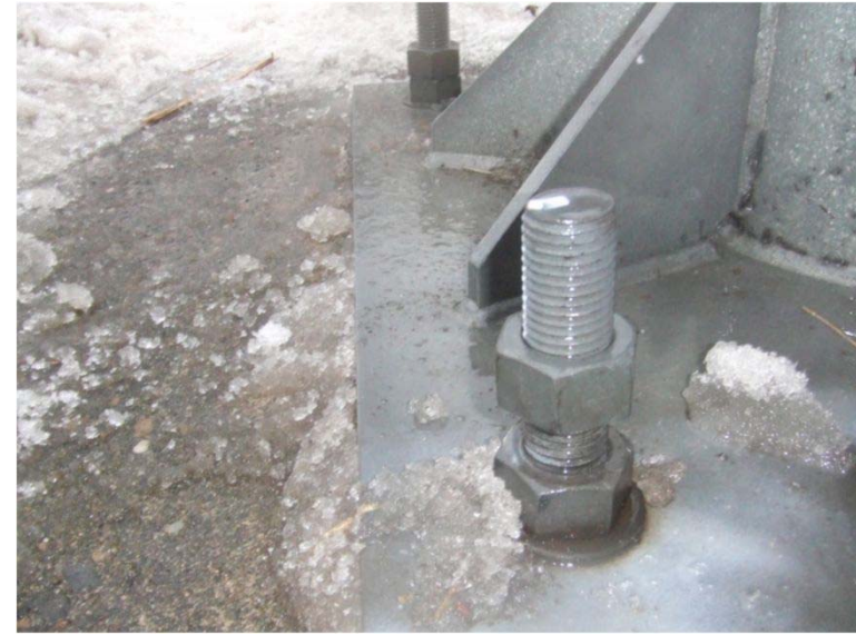
ボルトの緩み (施工不良)
