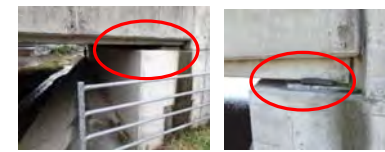
支承交換の作業空間なし
