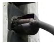
ケーブル損傷例
