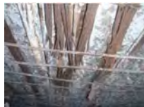
PC鋼材の腐食例
