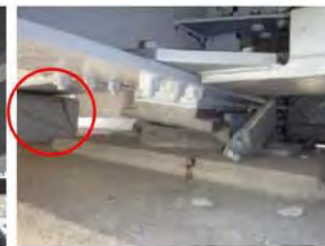
写真-6 支承の破損の状況
