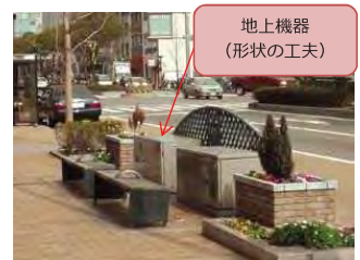
地上機器の工夫事例（神戸市）
