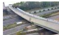
跨道橋の落橋
