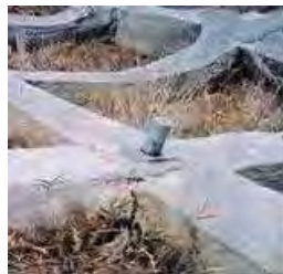
写真 受圧構造物の破損の例
