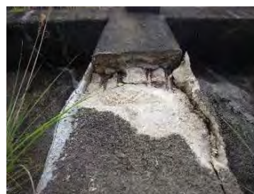
法枠工の老朽化損傷
