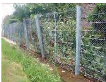
写真 落石防護柵の傾動の例
