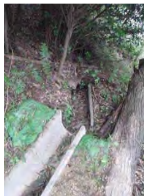
写真 排水溝の破損の例
