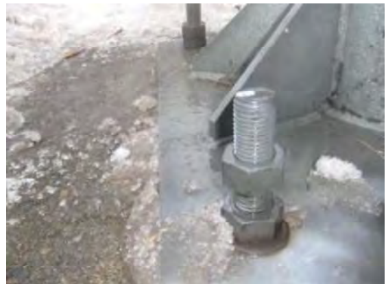
ボルトの緩み (施工不良)
