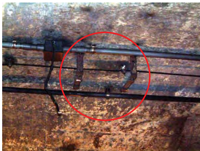
落下後の照明取付け部
