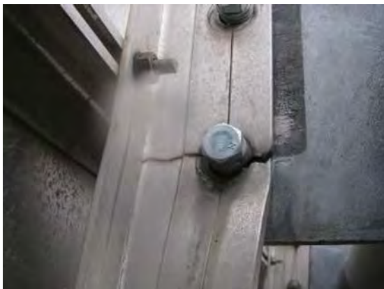
き裂損傷 (車両衝突)
