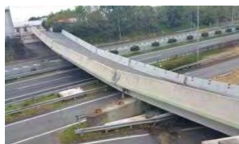
ロッキング橋脚を有する橋の落橋
