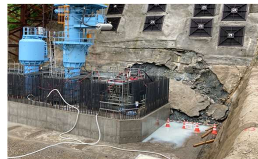
写真2 崩壊した切土法面
