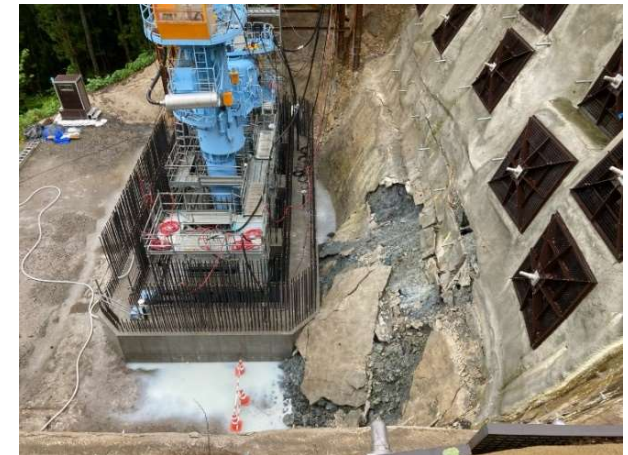
写真2 【対策前】崩壊した切土法面
