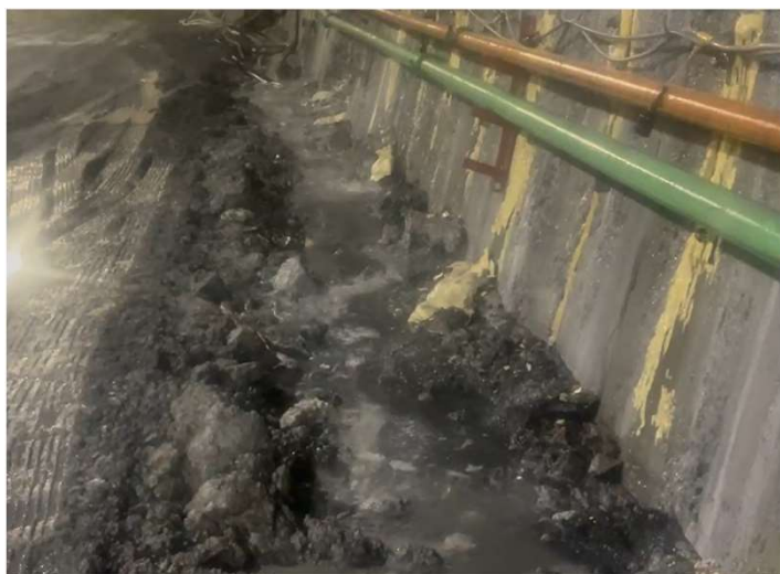
写真1 トンネル抗内に流れるの湧水状況（大谷トンネル）
