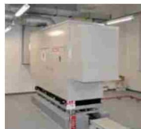
非常用発電設備のイメージ
