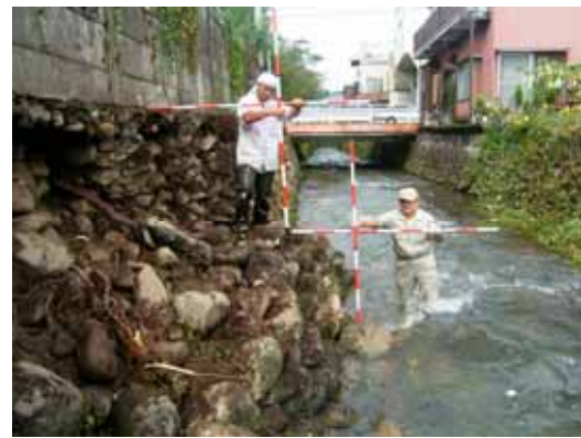
大蓮寺川 護岸被災（勝山市元町）
