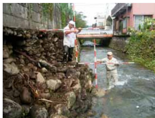
大蓮寺川 護岸被災 (勝山市元町)
