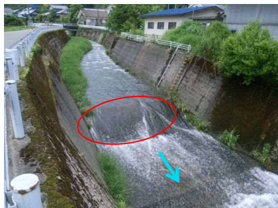
落差工が急勾配なため、遡上困難。
