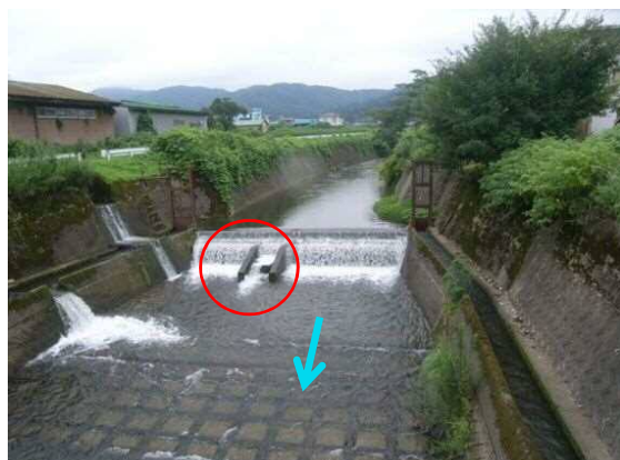
魚道幅が狭いため、遡上困難。
