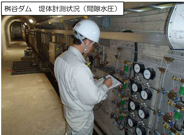
柘谷ダム 堤体計測状況（漏水量）
