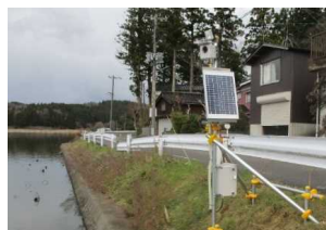
簡易型河川監視カメラ
