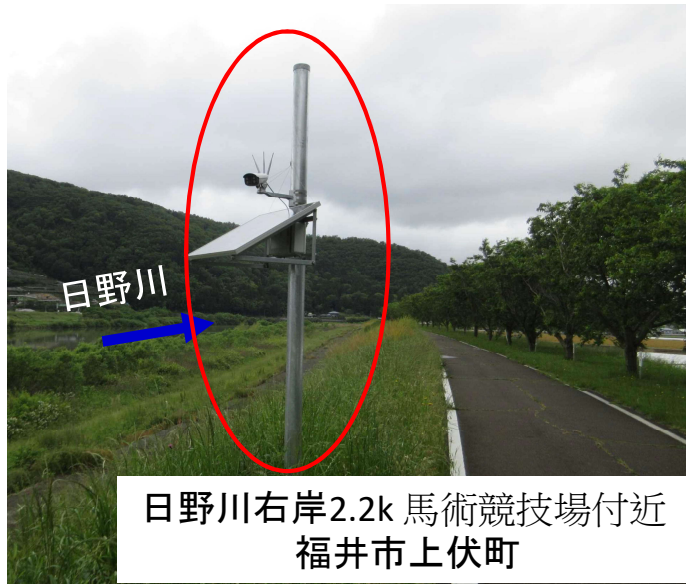
簡易型河川監視カメラ 設置
