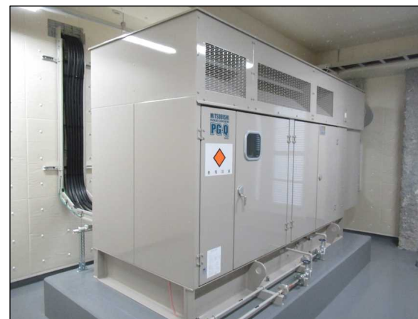
非常用発電設備
