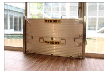
1階の可動扉に設置する防水板
