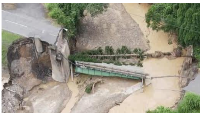
落橋（鹿蒜(加ル)川）
