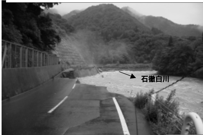
○ 県道白山中居神社朝日線の崩壊（和泉村三面地先）
