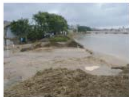
足羽川流域(福井市春日付近:破堤)
