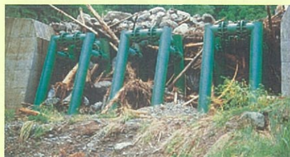
巨礫捕捉状況(事例)
