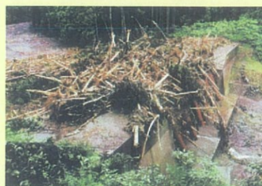
流木捕捉状況(事例)
