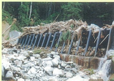
流木捕捉状況(事例)
