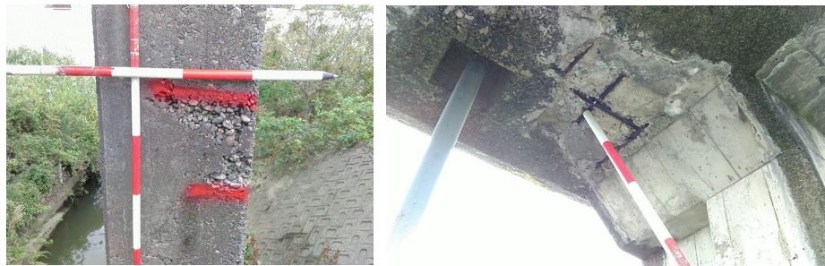
樋門本体の老朽化(九頭竜川 許可工作物)
