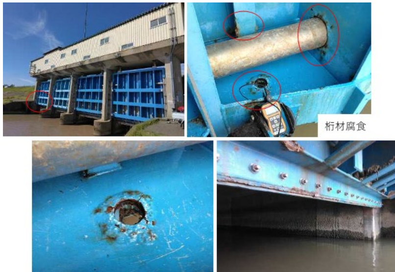
樋門ゲートの老朽化(片川放水路樋門4号ゲートの腐食)
