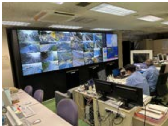
道路情報室(CCTV画像監視状況)
