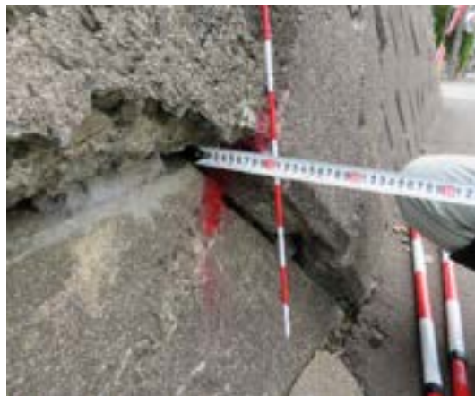
壁面変状(ズレ)状況
