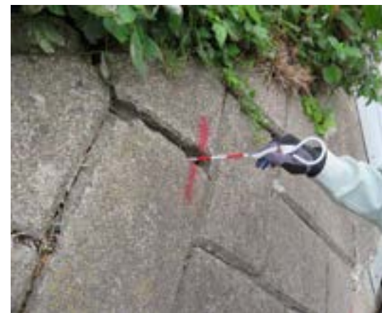
変状(ポール貫入)状況
