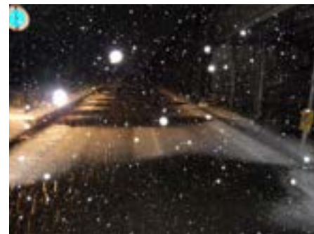
散水融雪設備の作動状況
