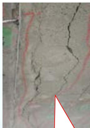
橋梁のひび割れ
