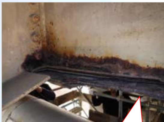
鋼桁の腐食が進行
