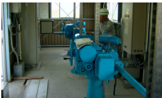
樋門施設の保守
