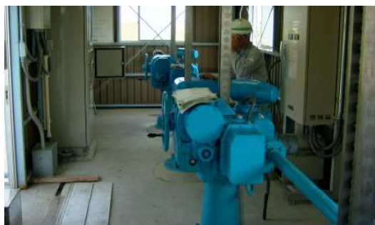
樋門施設の保守
