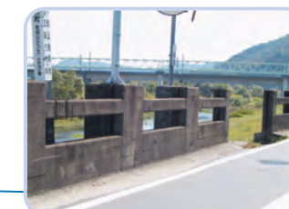
たつの市内の3箇所を設置されています。総延長は3100m余 兵庫県 たつの市正條
