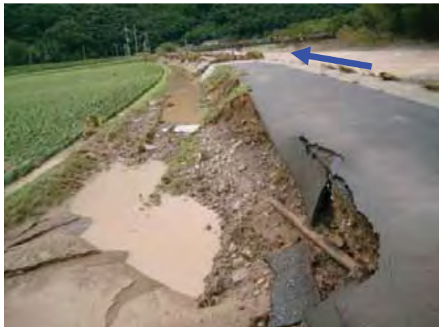
越水による堤防背面の侵食
