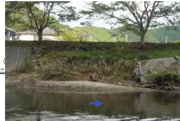
流水による護岸の崩壊
