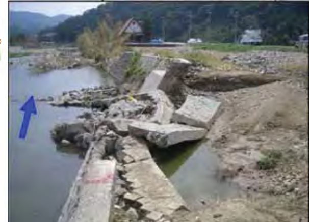
流水による護岸の崩壊
