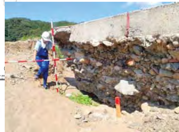
越水による護岸背後の侵食
