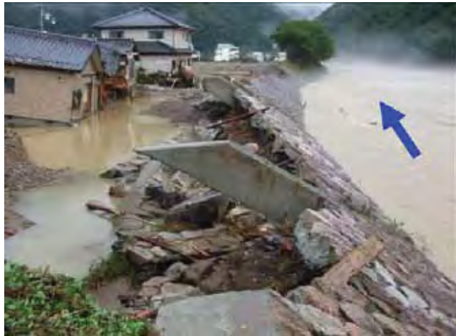
越水による堤防損壊
