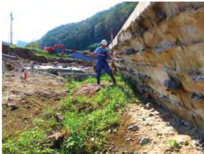
越水による護岸背後の侵食
