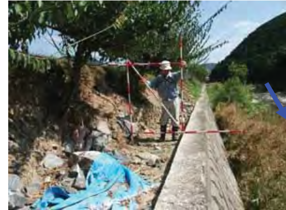
越水による堤防の侵食
