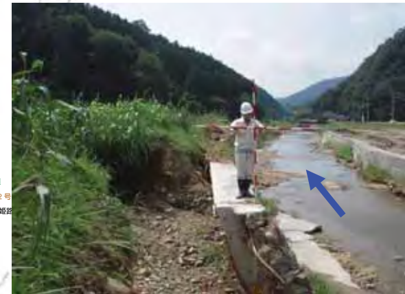
越水による護岸裏の侵食
