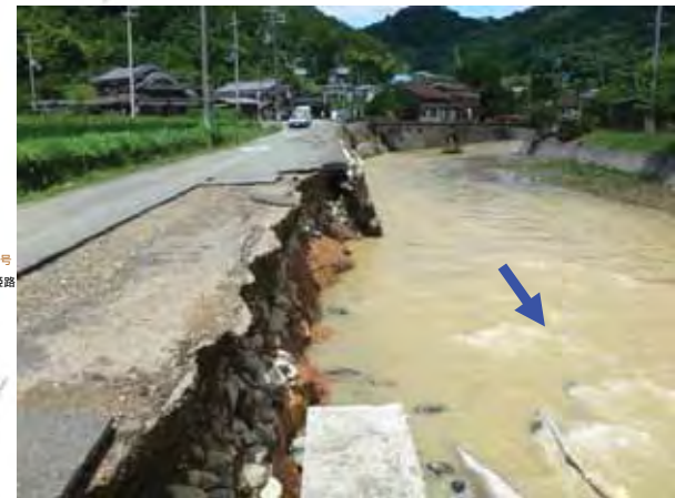
流水による護岸の崩壊 16
