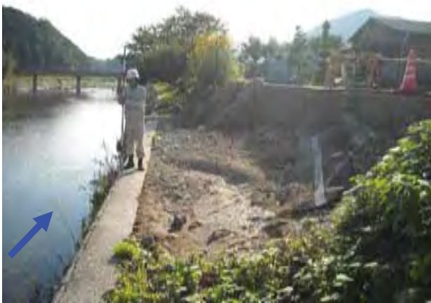
越水による堤防の侵食
