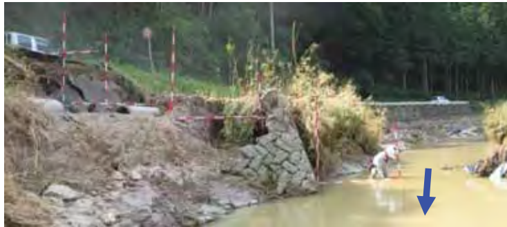
越水による護岸の崩壊
