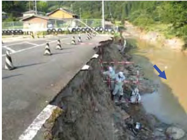
流水による護岸の崩壊
