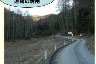
砂防堰堤工事により設置した工事用道路は間伐材の搬出等に活用。
