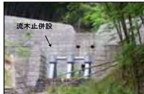
従来の砂防えん堤・治山ダムに流木止を併設
